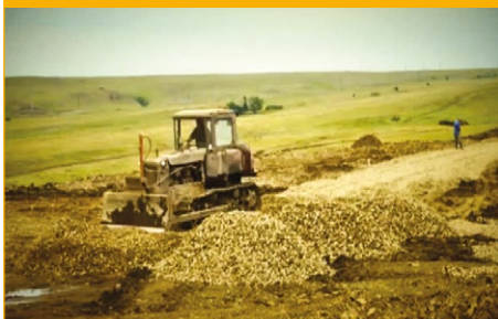
Рис. 9, 10, 11. Пошкодження ландшафту при будівництві Краснодонської ВЕС
