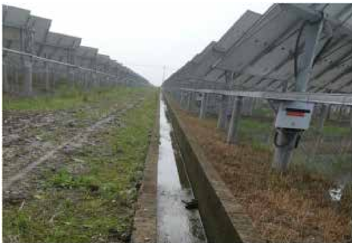
图 10 光伏板下排水沟
