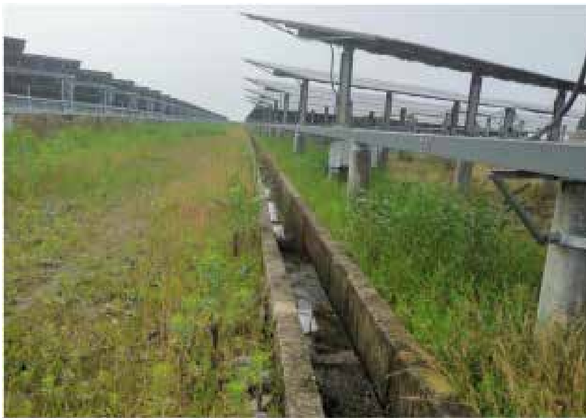
图 11 光伏板下排水沟
